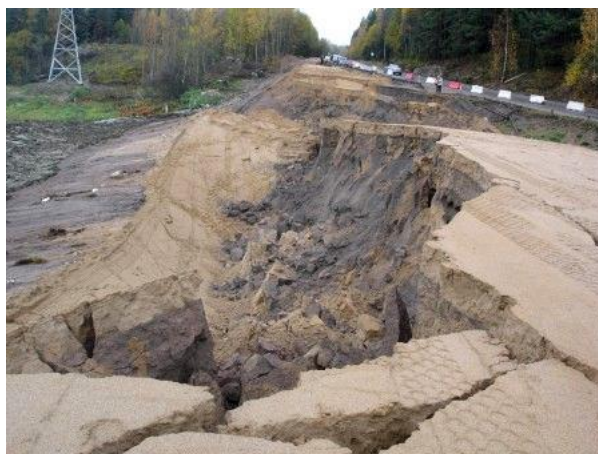
Рисунок 1– Общий вид аварийной ситуации, созданной структурно неустойчивыми основаниями откосного массива под собственной нагрузкой
