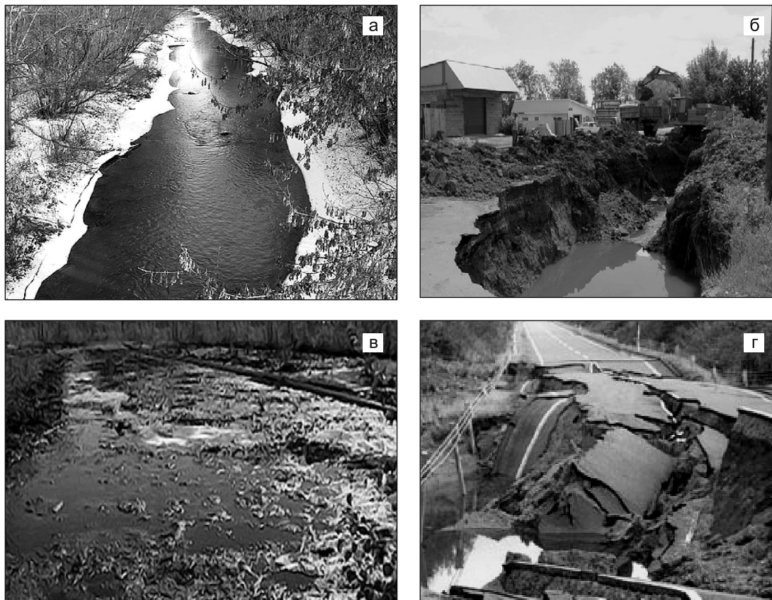
Рис. 11. Последствия аварий на канализационных сетях: загрязнение стоками территории и водоемов (а,б) , нарушение ландшафтов (в), разрушение дорожных коммуникаций (г)
