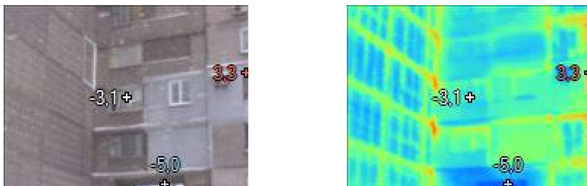
Рисунок 4 – Некачественная теплоизоляция фасадной системы здания, а также теплотери через стыки стеновых панелей
