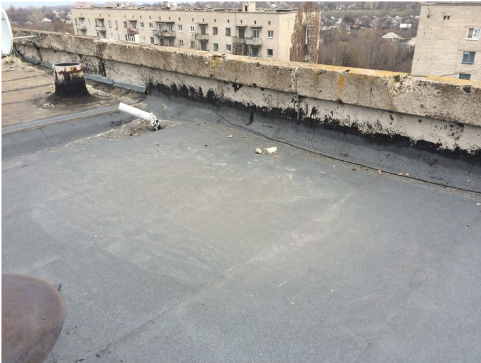
Рисунок 3 — Солевые пятна на кровельном покрытии
