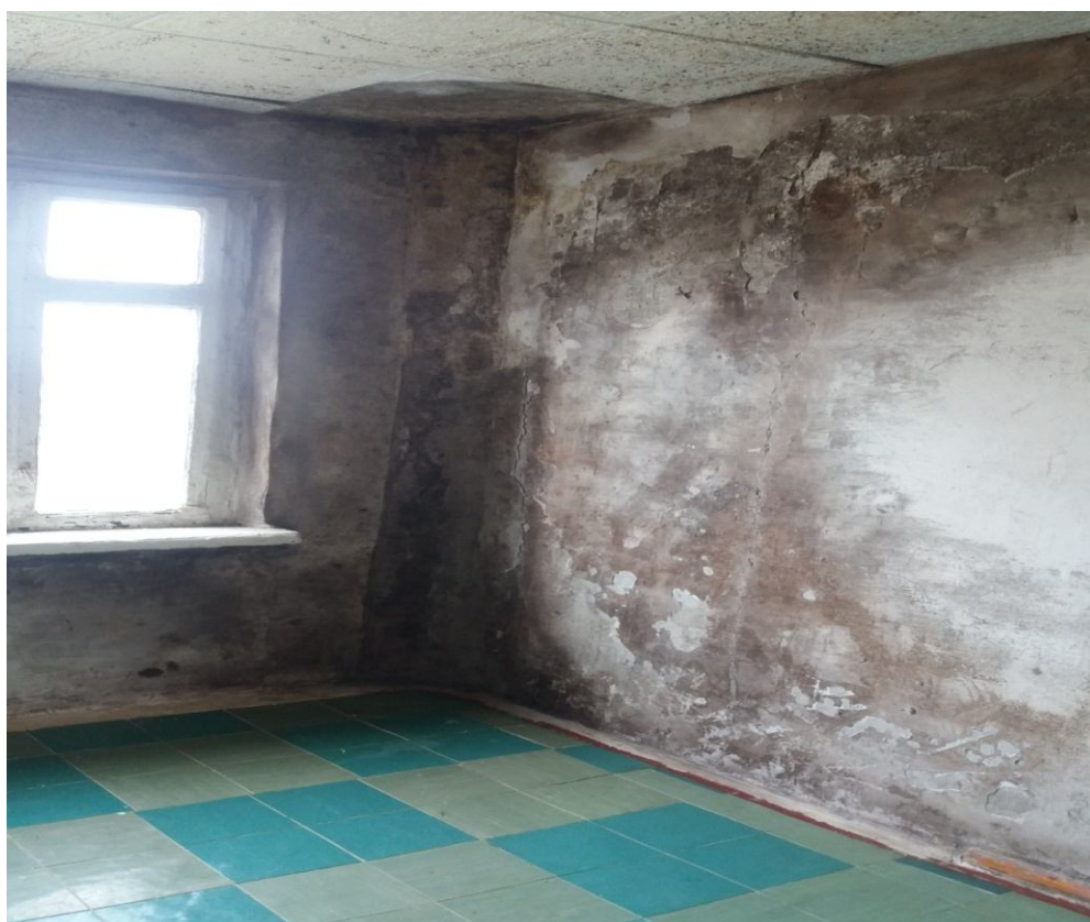
Рисунок 6 — Последствия протекания в результате смещения между парапетными блоками
