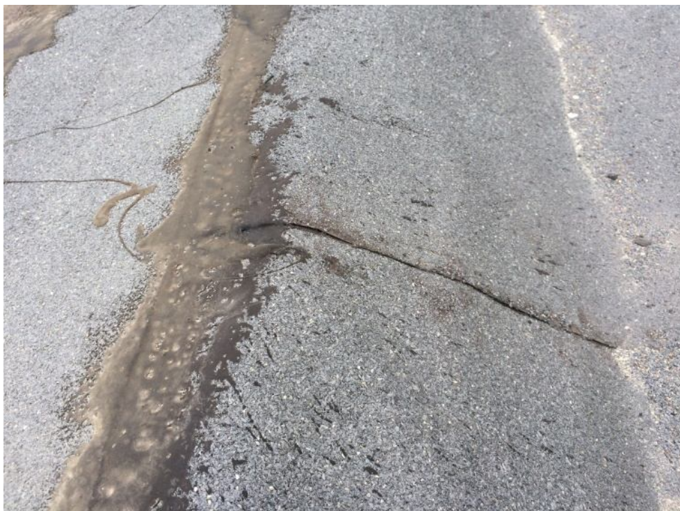
Рисунок 4 — Отслаивание покрытия от основания в местах стыковки
