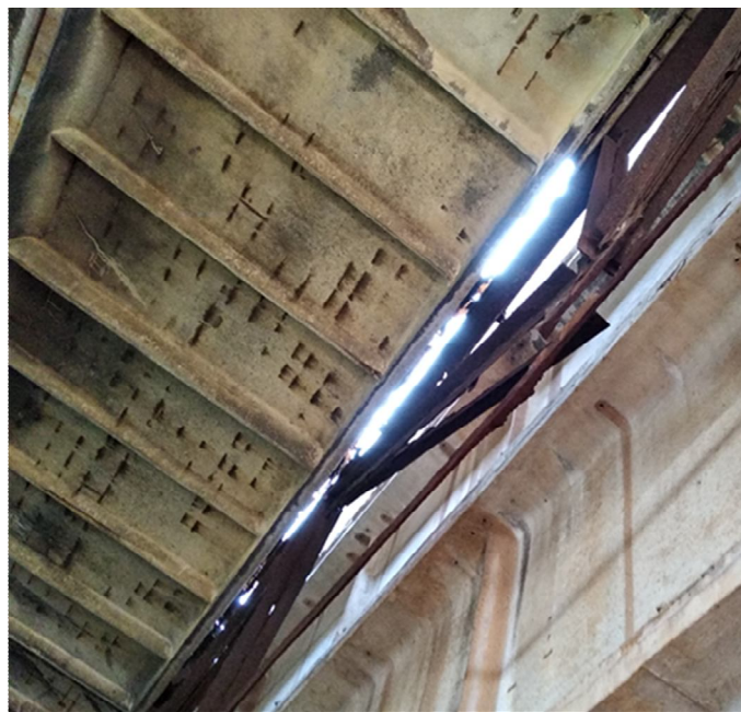
Рисунок 2 Отсутствие защитного слоя бетона на плитах покрытия, коррозионное поражение оголенной арматуры. Глубина повреждения бетона до 40 %
