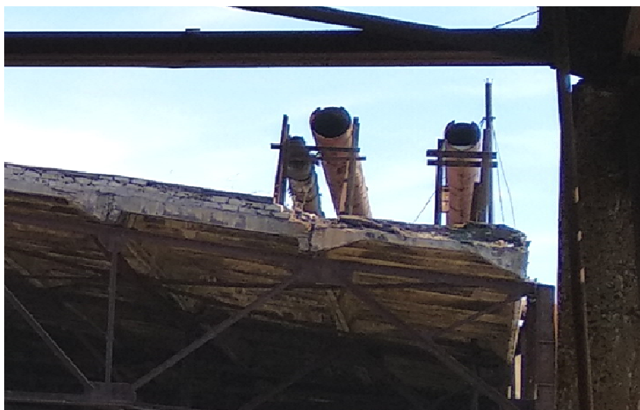
Рисунок 3 Технологические трубопроводы, расположенные на покрытии здания сортопрокатного цеха
