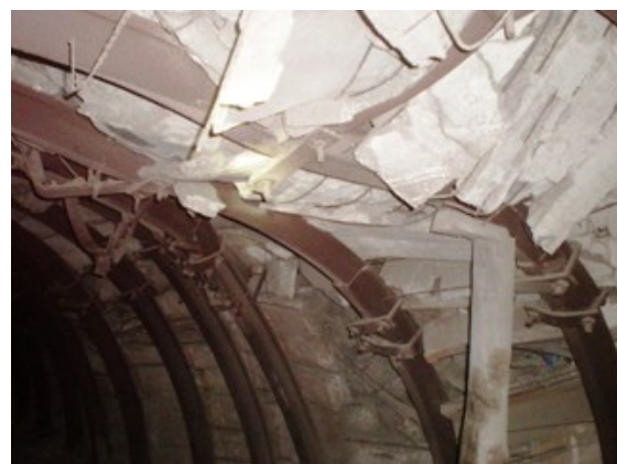
Рисунок 6 Деформации верхняков, стоек и затяжки арочной крепи в том же вентиляционном штреке
