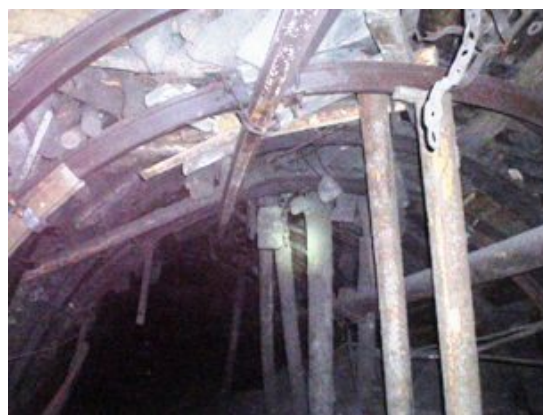
Рисунок 7 Деформации верхняков, стоек и затяжки арочной крепи в западном полевом вентиляционном штреке гор. 714 м
