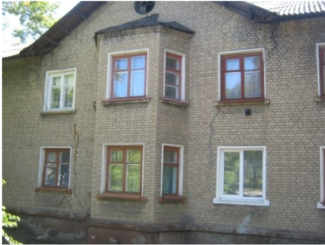
а – деформация оконных перемычек на фасадной стене и сеть многочисленных трещин от 1 до 10 мм (в местах вывала раствора до 20 мм)
