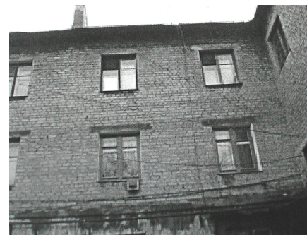
б – разрушение кладки стен над и под оконными проемами стены, диагональные трещины в простенках в уровне третьего этажа
